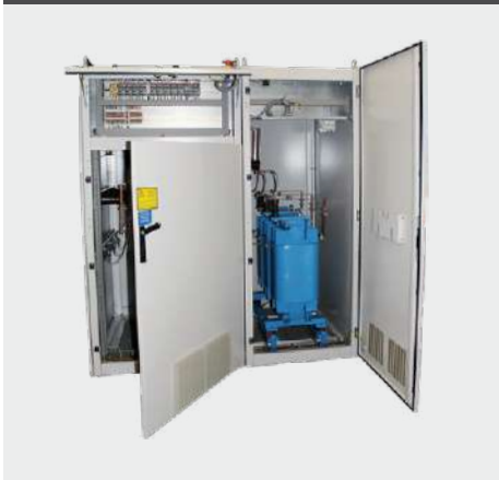
Baterías de condensadores de media tensión: E-COMP
