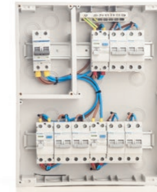
2 Amplio espacio para el cableado. Wide space for the cabling.
