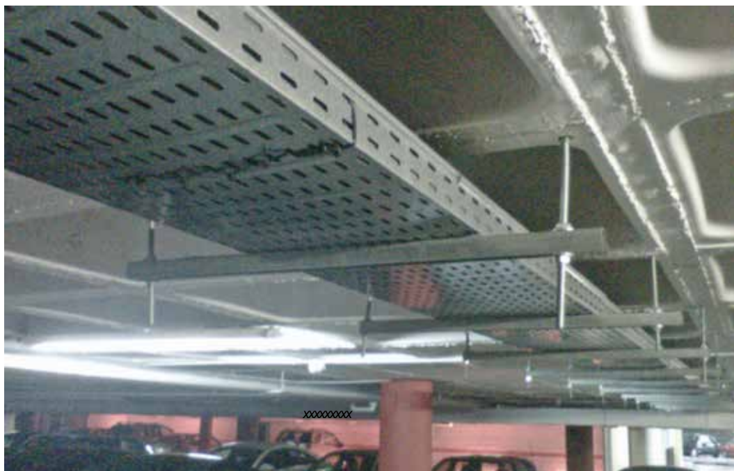
En las bandejas deben instalarse cables con aislamiento (función eléctrica de soportar tensión) y cubierta (función mecánica de proteger el aislamiento y conductor).
