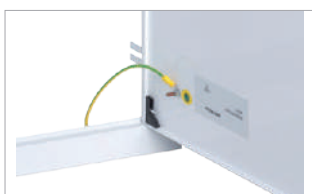
Cable de conexión a toma de tierra
