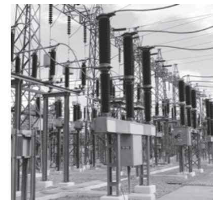
Proyecto subestación eléctrica, Qatar QEWC Electrical substation Qatar project QEWC
