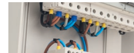
Amplio espacio para el cableado Wide space for cabling
